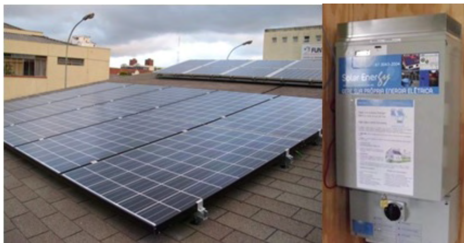
Figura 93: Vista dos painéis do EV e do inversor - Sede Centro [6] [59].
