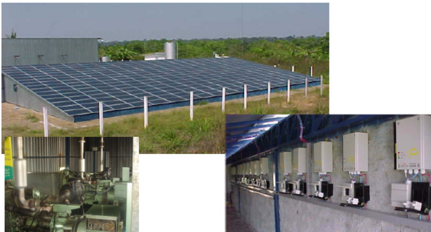
Figura 90: Sistema isolado híbrido fotovoltaico-diesel instalado em Nova Mamoré [19] .
