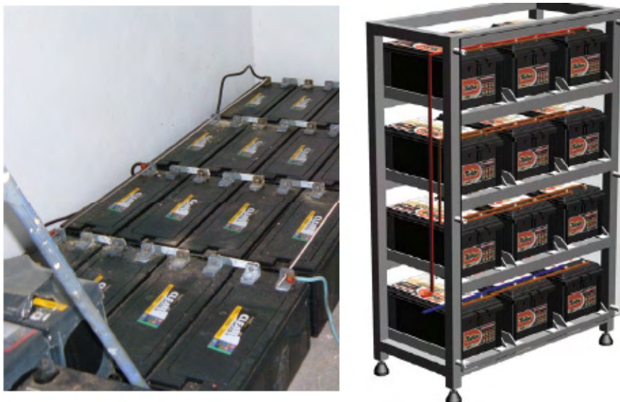
Figura 82: Banco de baterias [19] .
