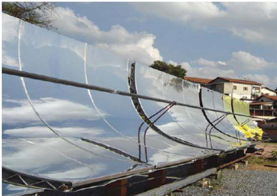
Figura 17: Concentrador solar térmico [19] .
