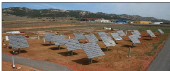
Planta fotovoltaica com concentrador
