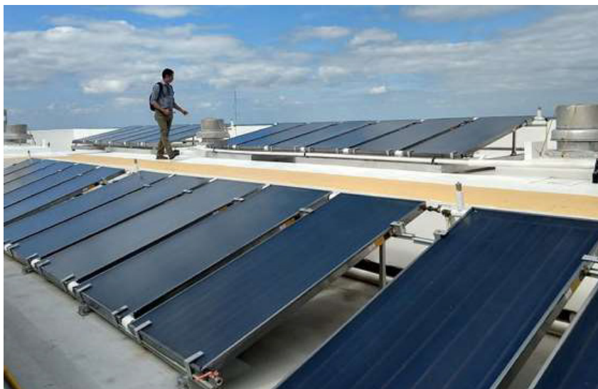
Figura 16: Coletor solar térmico [19] .
