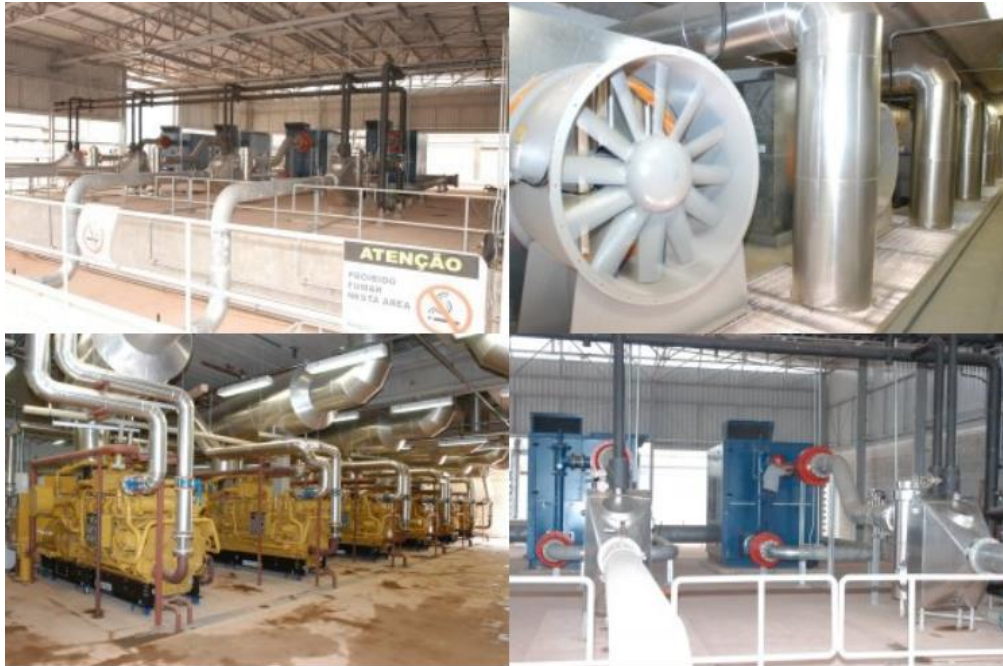
Figura 34 Instalações da unidade de geração elétrica com biogás do Aterro Sanitário Bandeirantes, em São Paulo
